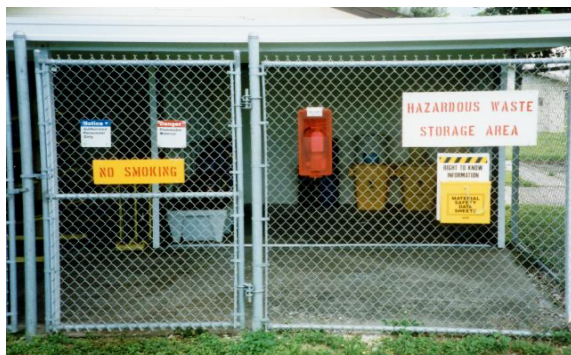
Slika 2. Propisno izgrađeno skladište opasnog otpada
